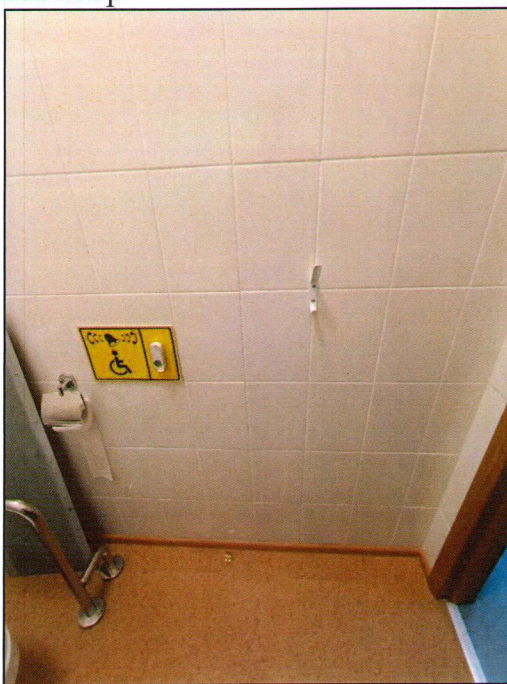
71.Вызывное устройство в санузле
